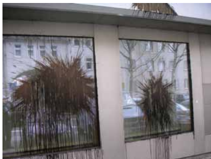
Die beschädigte Hausfassade.
